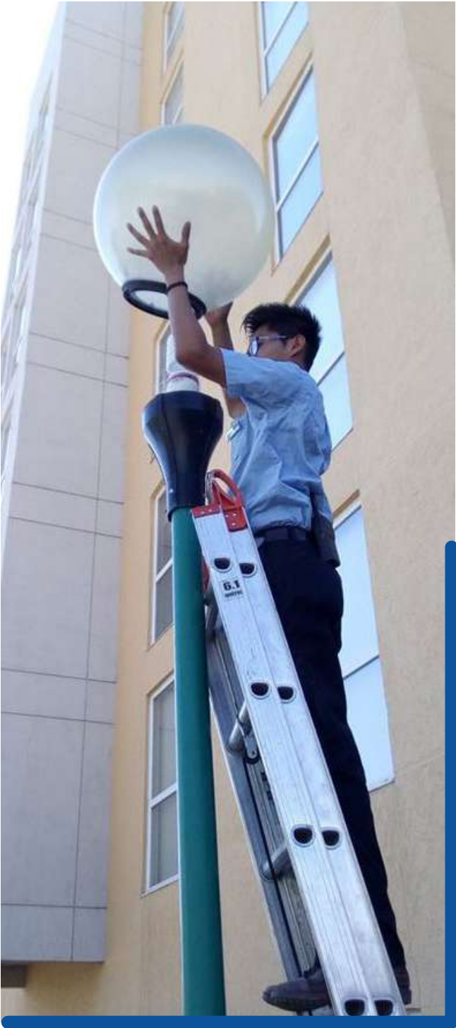
Mantenimiento constante del Sistema Energético
